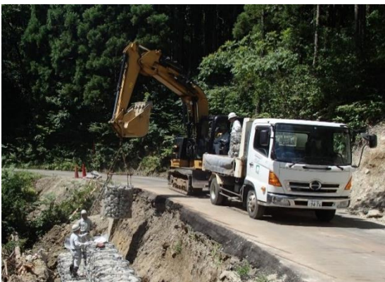
a) 設置状況
