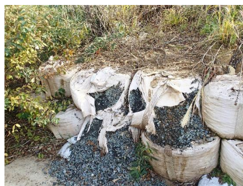
写真-1 大型土のうの劣化 (宮城県仙台市：東日本大震災により被災)
