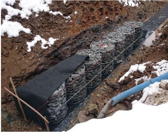
a) 設置状況
